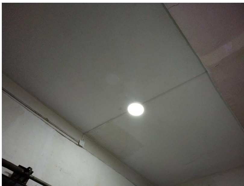
FIGURA 10 . ILUMINACION ARTIFICIAL . ARCHIVO CENTRAL AREA 4
