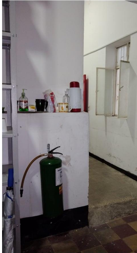
FIGURA 12. Extintor externo parte de consulta Categoría A, verde. ACTUALIZADO EN ABRIL 2022
