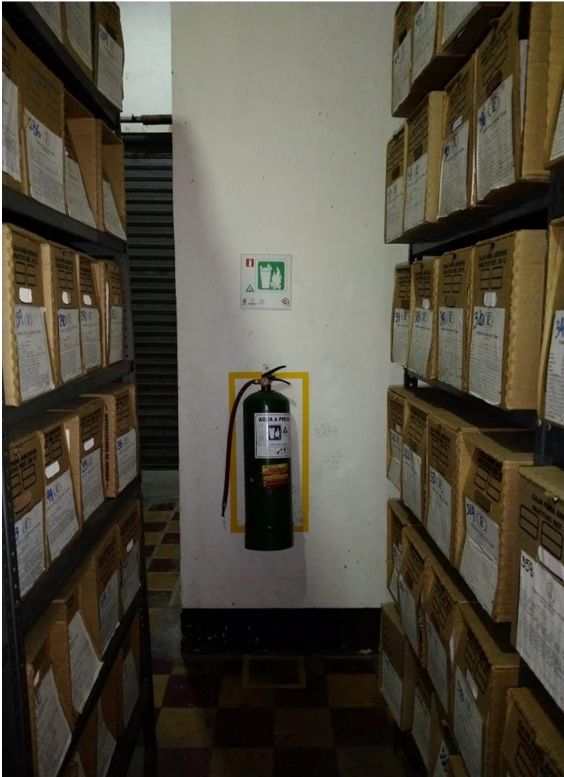
FIGURA 11. Extintor interno parte principal archivo Categoría A, verde. ACTUALIZADO EN ABRIL 2022
